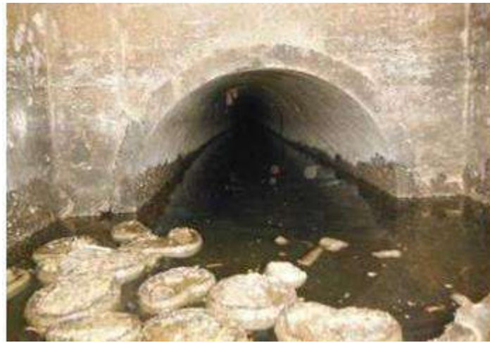
Figura 42 – Immagine del pozzetto a monte del tratto sifonato
